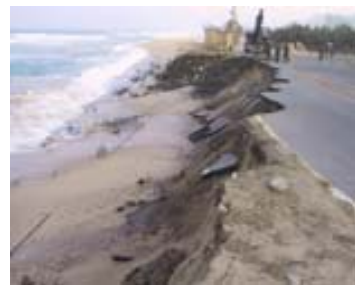
해일 및 이상고파로 인한 해안도로 붕괴
