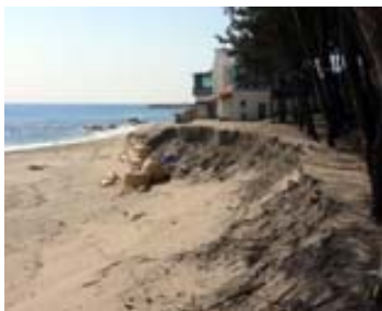
연안침식에 의한 해안가 건축물 붕괴
