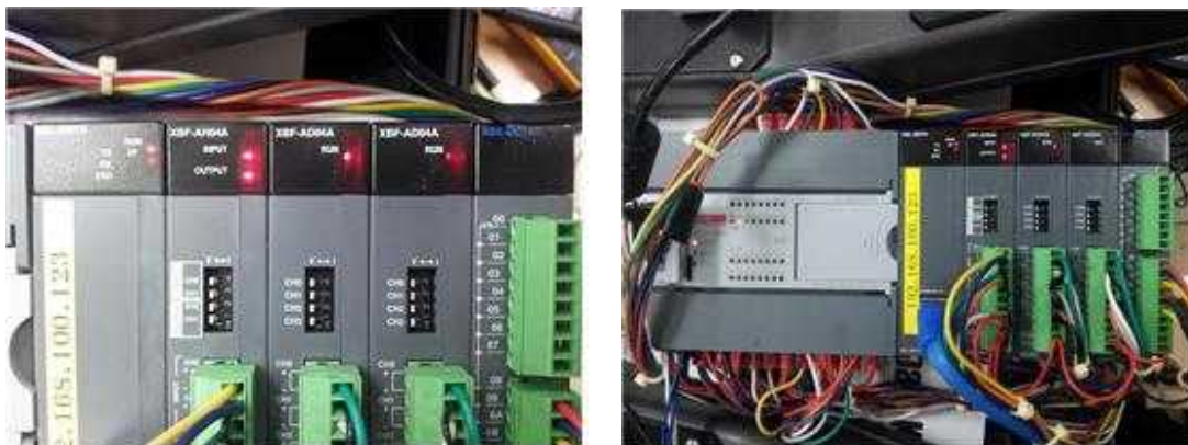
그림 5.2.5 오퍼레이팅 시트 제어판넬 제어용 PLC
