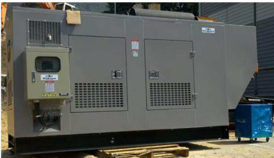
그림 1.1.24 발전기 옥외 방음형 프레임 및 변압기
