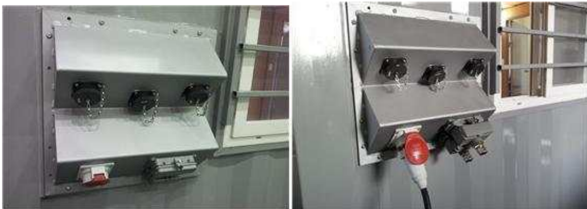
그림 4.1.5 전원 및 통신케이블 인입부의 운영실 설치
