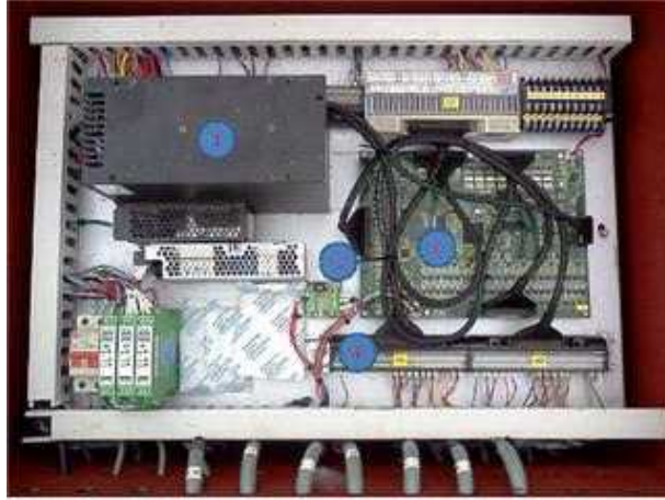
그림 2.5.8 방수케이스에 설치된 구동용 제어기
