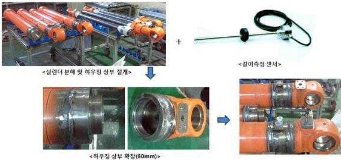
그림 2.1.8 실린더 길이 측정 센서 (MTS) 설치공정
