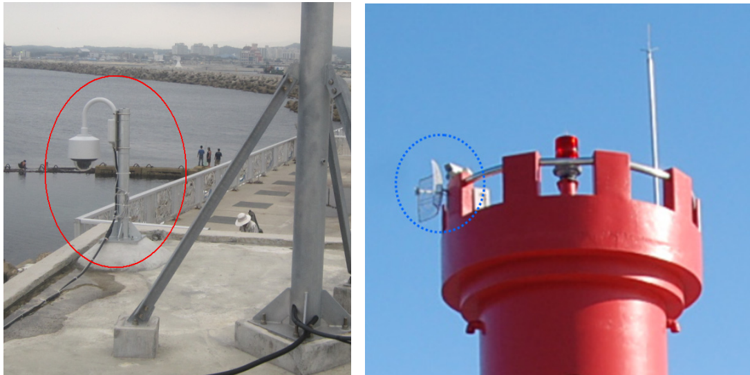
그림 3-7. 감시용 및 (등대) 관측용 CCTV 카메라 설치사진
