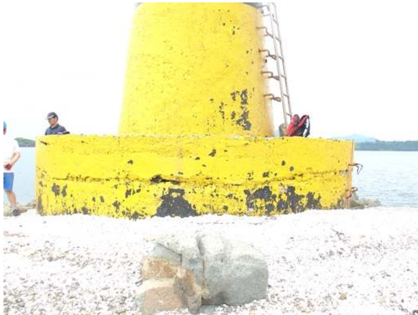
<그림 3-2-8> 여초 등표 현장조사 사진 - 세굴상태(남향)
