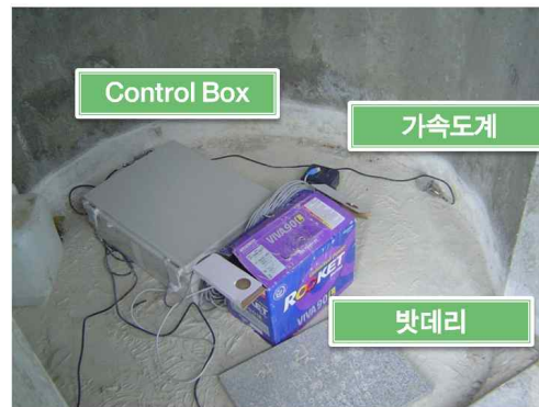
(b) 설치된 축전지실 내부
