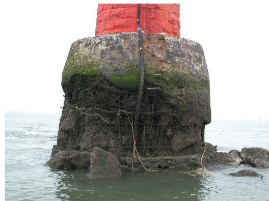
<그림 1-2-3> 을호 등표 기초 파손 전경
