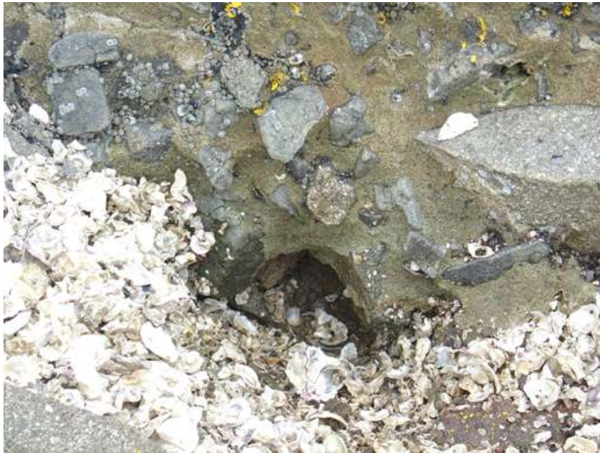
<그림 3-2-10> 여초 등표 현장조사 사진 - 세굴상태(확대)
