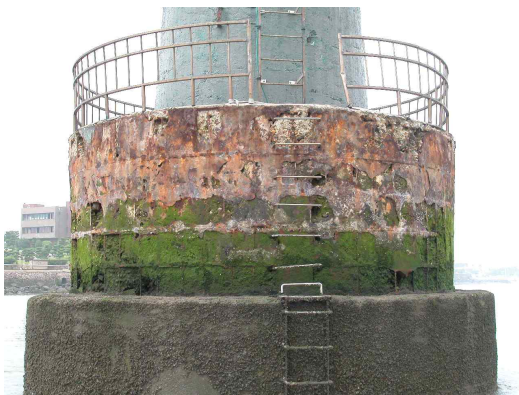
<그림 1-2-2> 전망산 등표 기초 파손 전경
