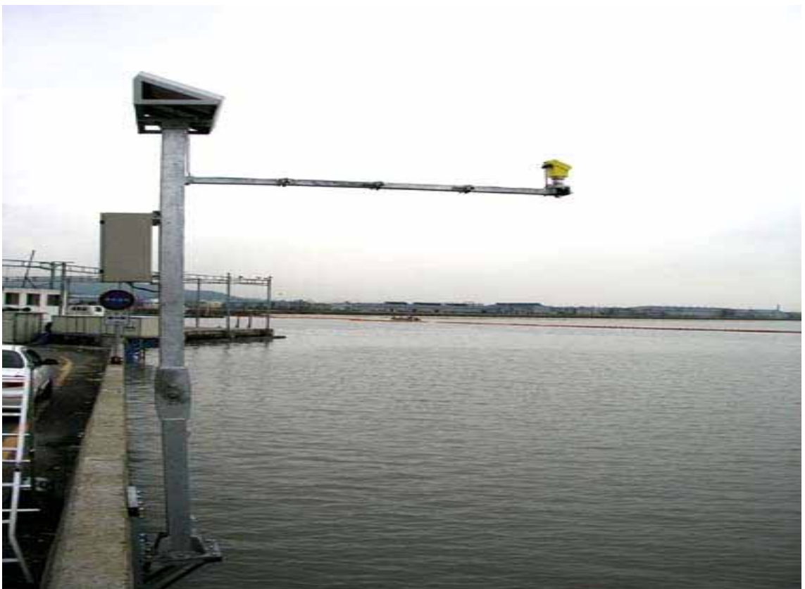
그림 2.1.2 레이더식 실시간 해수위계 설치 사진.
