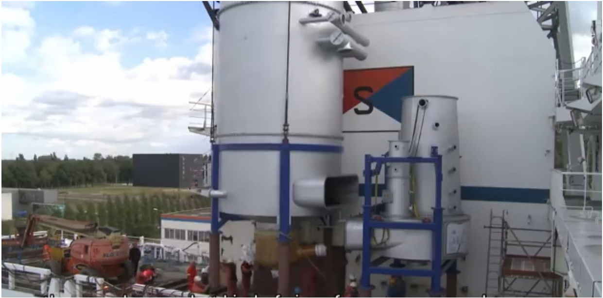
<그림 4.32> Alfa Laval사 SOx Scrubber의 설치 (M/V Plyca)
