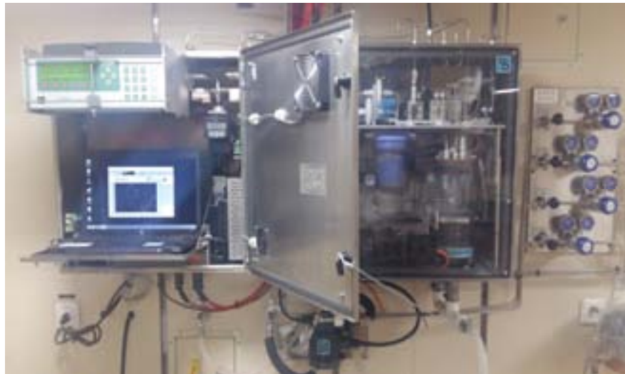
<그림 3-129> 표층수온염분도 pCO2 측정기 설치 사진
