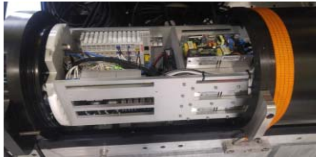
[Power Can 전원 공급부]
