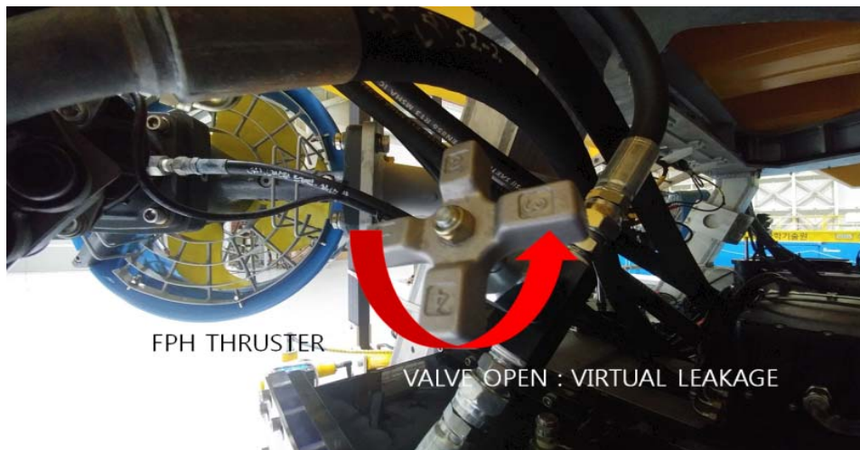
[ROV 추진기 및 추가 설치된 바이패스 밸브]
