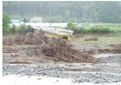
写真-6.4.2 アプシトエナイ橋の被災状況
